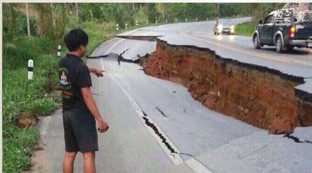
Рисунок 33. Трещина, образованная в результате землетрясения
